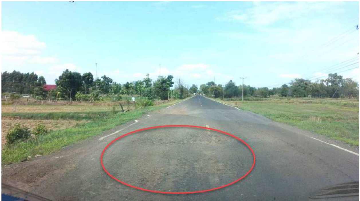
ก่อนดำเนินการ เส้นทางตรง แต่ถนนเสียทั้ง ๒ ข้าง มีหลุมใหญ่มาก ไม่มีสัญญาณเตือน
